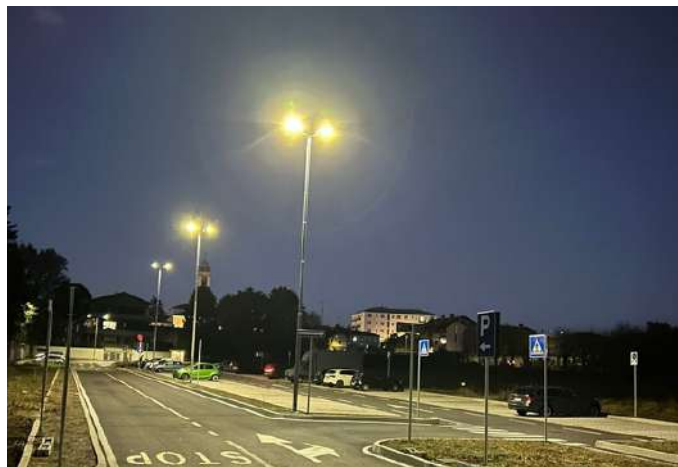
ILLUMINAZIONE NUOVO PARCHEGGIO
